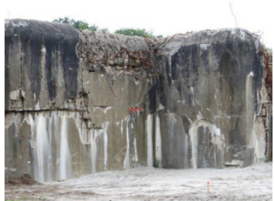
Detail van de bunker kort na de desastreus verlopen poging tot opblazen met explosieven in 2008 (foto: garage De Bilt uit 2013).
