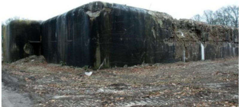
Desolate aanblik na de mislukte poging in 2008 om de bunker op te blazen (foto: L.C. van der Weel, Stichting Bunker Behoud).
