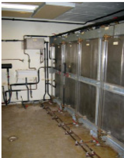
Schokbestendig opgestelde opslagtanks voor drinkwater geplaatst tijdens de grote renovatie in 1977/1982 (foto: L.C. van der Weel, Stichting Bunkerbehoud).
