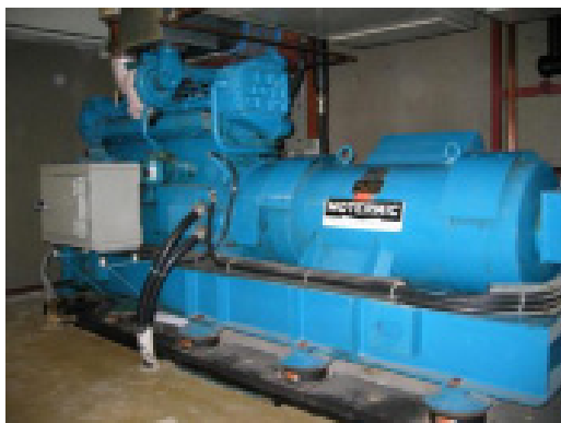
B 300 KVA diesel noodstroomaggregaat geplaatst na de renovatie in 1982 (foto: L.C. van der Weel; Stichting Bunkerbehoud).
